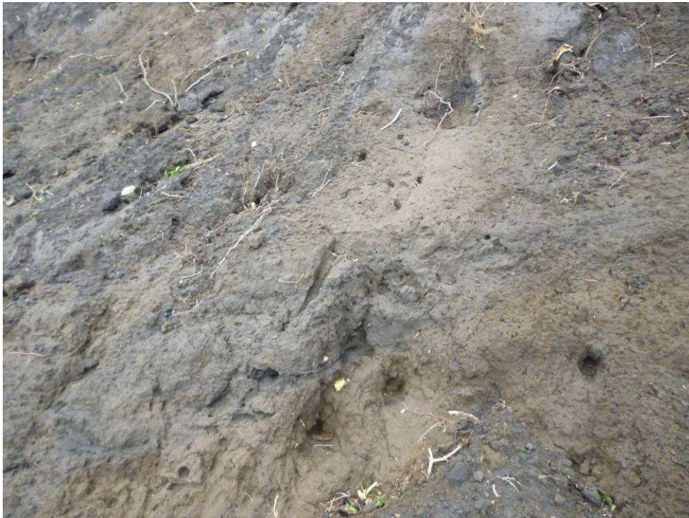
写真2：御神火スカイライン上方の崩壊斜面に見られたパイピングホール。
