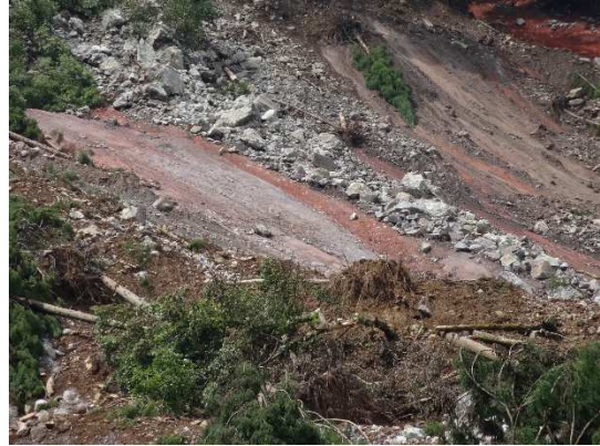
写真6：上部ブロックに露出したすべり面。
