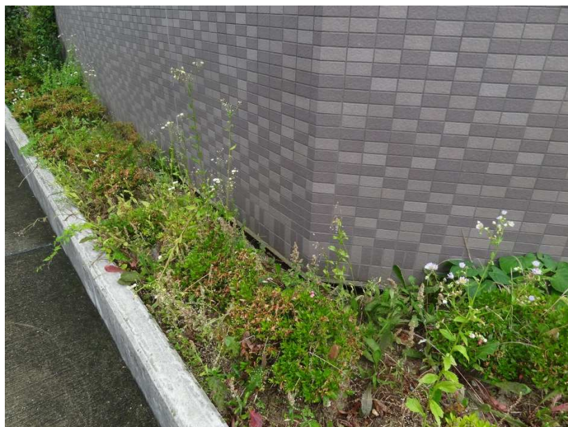
写真3：マンションの敷地における地盤沈下。
