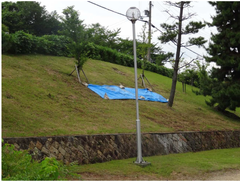
写真4：公園の斜面上方の亀裂。
