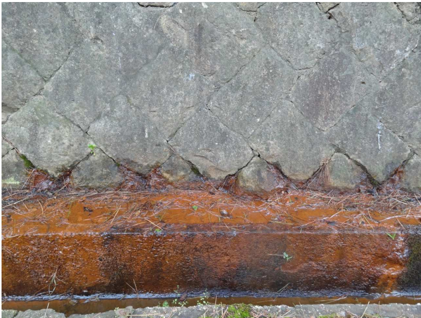
写真5：公園の東端（斜面の末端部）において確認された湧水。
