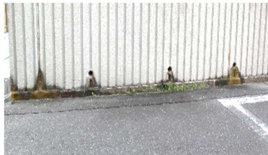
写真9：谷頭に位置する擁壁のパイプからの排水。擁壁の継ぎ目からも水が出ている。
