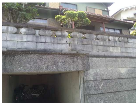
写真5：山之上五丁目におけるブロック塀・擁壁の被害。
