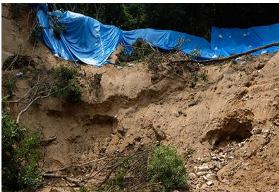
写真 3 土石流源頭部の崩壊。弱く成層した高位段丘堆積物と下部の巨大な地下水噴出孔。
