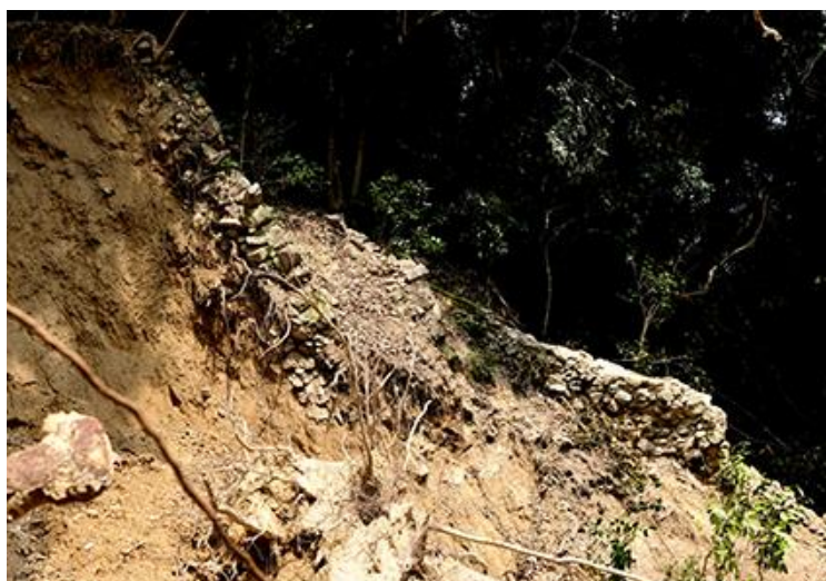
写真5 崩壊末端部に位置する土砂止めの残骸。わずかなセメントで固めただけの構造物だった。
