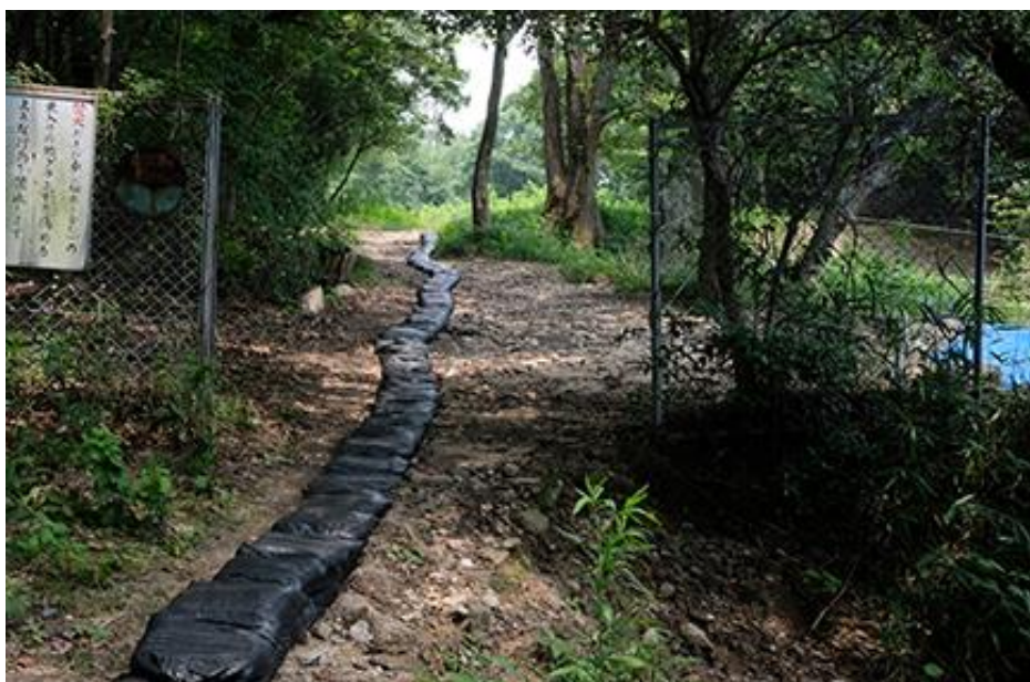
写真 4 崩壊背後の平坦地と散乱する礫（地表水の流下跡）
