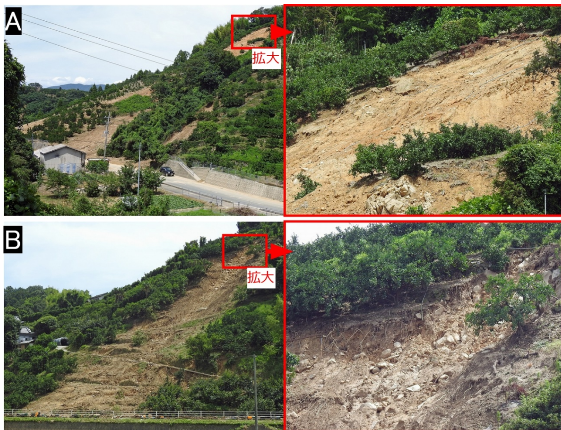
第 11 図 表層崩壊の発生状況に関する例（位置は第 9 図上に記載）
