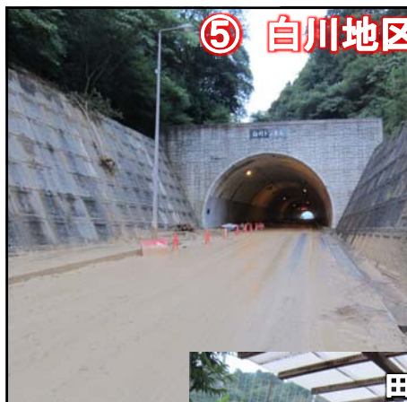
白川トンネル付近の土砂災害
