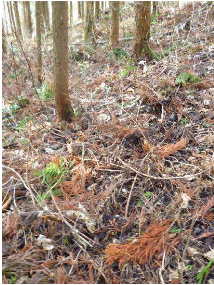
写真3：斜面中央部の段差亀裂
