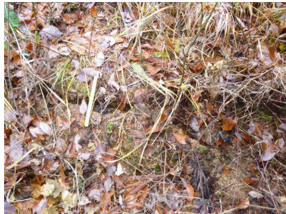
写真4：斜面中央部における開口亀裂
