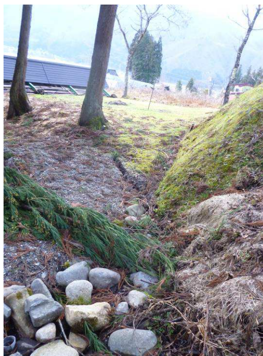
写真1：集落内の亀裂
