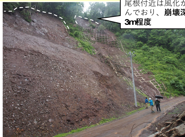
崩壊①：崩壊高さ70m、傾斜45°
