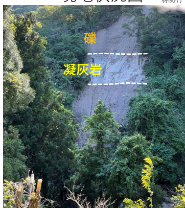
写真② 堆積岩の崩壊
